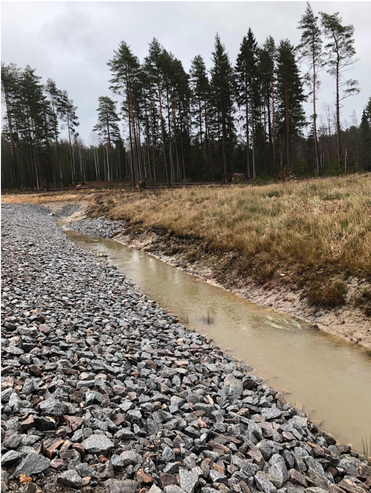
Erosion vid diket mot norra plangränsen.
